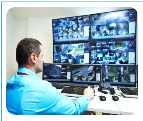
Rysunek 63: Pomieszczenie nadzoru CCTV
